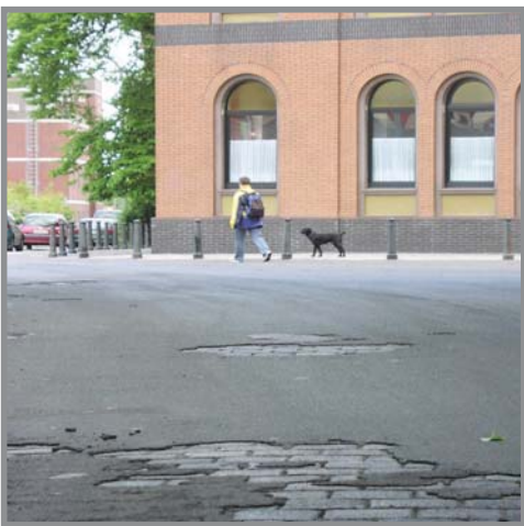
Tiefe Schlaglöcher machen einen Teil der Straßen und Gehwege im Quartier nur schwer passierbar. Im Bild die Ecke Hoheellenstraße/Reimerstraße.
