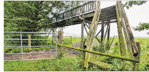
Viele Treppenstufen fehlen. Die Brücke ist gesperrt und kann daher schon seit mehreren Jahren nicht mehr genutzt werden.
