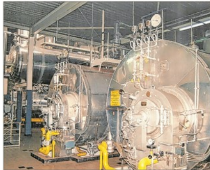
So sah es im Kesselhaus aus.
