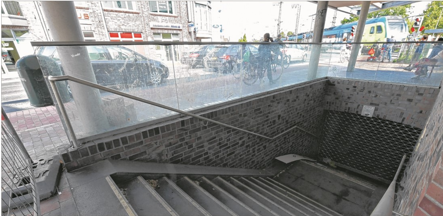
Der Fußgängertunnel der Bahn in der Bremer Straße ist seit September 2013 gesperrt und soll neugebaut werden.
