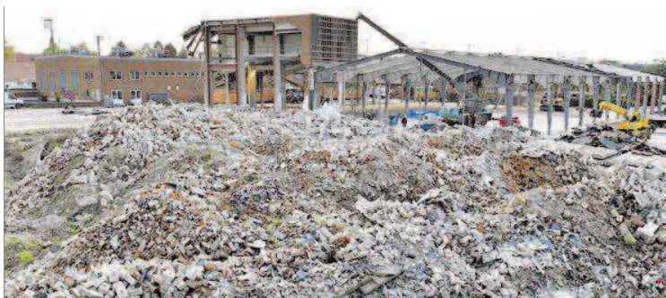
Vom ehemaligen Sonderpostenmarkt ist so gut wie nichts mehr übrig. Bis zum Jahresende sollen alle Gebäudeteile verschwunden sein.
