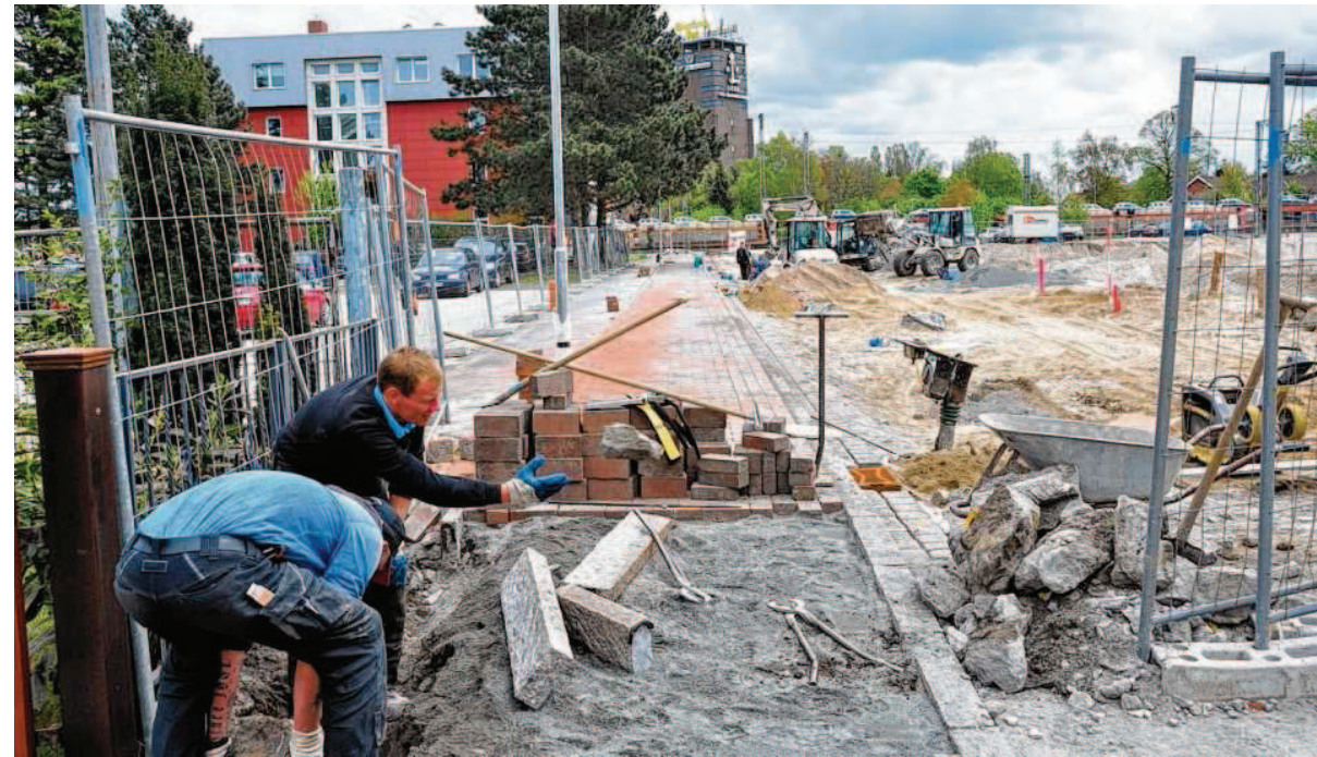
Die Christine-Charlotten-Straße verläuft künftig über das MZO-Gelände bis zur Großen Roßbergstraße. Auf der Strecke werden die Klinker vom Denkmalsplatz verbaut.
