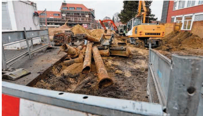
Im Rampen- und im Pumpengebäude (hinten) laufen die Umbauarbeiten auf Hochtouren. Zudem wird der Bau des neuen Straßenabschnitts auf dem Gelände vorbereitet. BILD: ORTGIES
