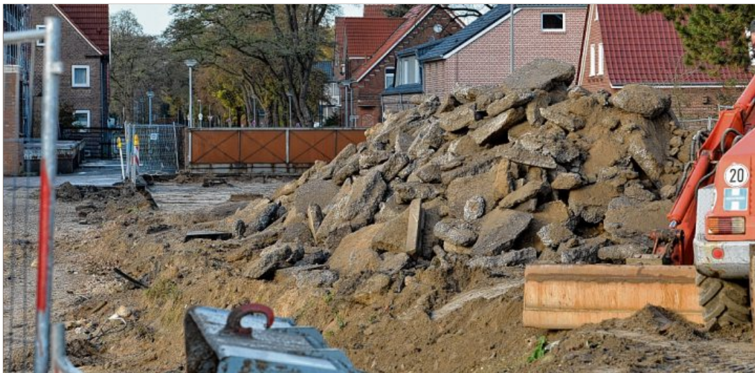
Mit schwerem Gerät wurde die alte Asphaltdecke auf dem MZO-Gelände aufgebrochen. Hinter dem Tor befindet sich die Christine-Charlotten-Straße.
