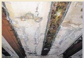
Ein Blick auf die Decke des gesperrten Tunnels. ARCHIVBILD
