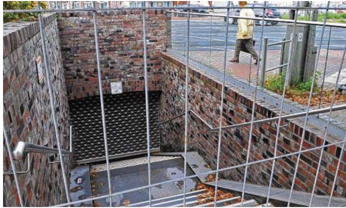
Die Unterführung an der Bremer Straße ist seit Monaten gesperrt – und wird es weiterhin bleiben. BILD: OZ-ARCHIV
