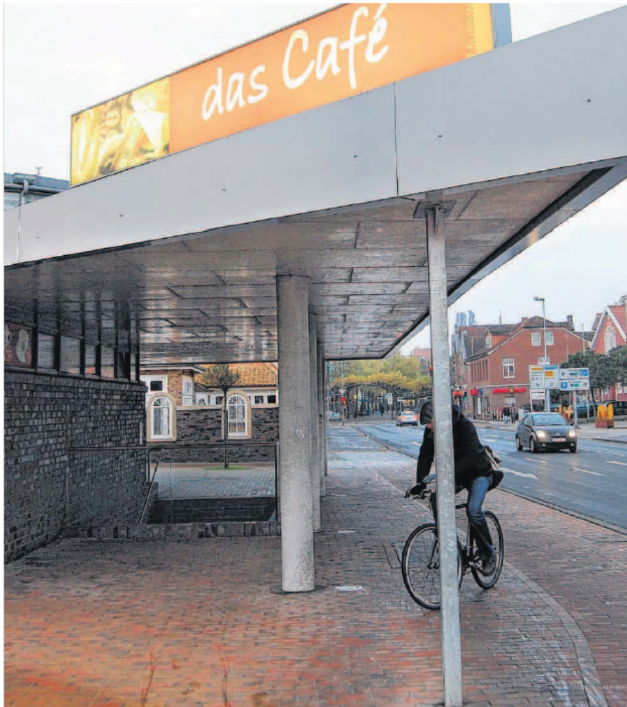
Die Metallstütze unter dem Dach des Pavillons am Bahnübergang Bremer Straße steht im Wege.
