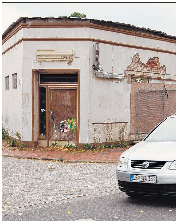
Viele Leeraner empfinden die Brandruine als Schandfleck. Wann sie abgerissen wird, ist noch offen.
