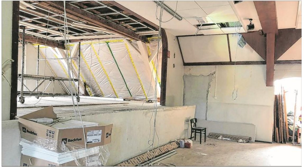
Die Sanierung der Aula der Hoheellernschule ist noch lange nicht abgeschlossen.
