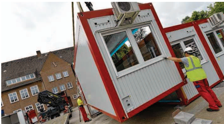
Anfang August wurden die ersten Container auf dem Schulhof aufgestellt. BILD: ORTIGES
