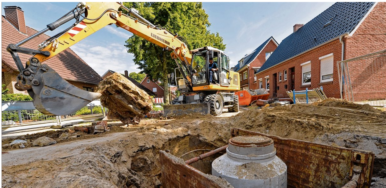
In der Straße Auf der Lübsche lassen die Leeraner Stadtwerke durch die Emdener Firma Huchtmann die Kanalisation erneuern.
