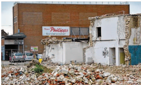
Die Abrissarbeiten sind schon weit fortgeschritten. In den Resten des weißen Gebäudes ist der Gewürzhandel.
