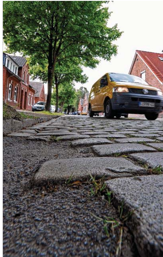
Die Ulrichstraße ist sanierungsbedürftig. Überall gibt es tiefe Schlaglöcher.
