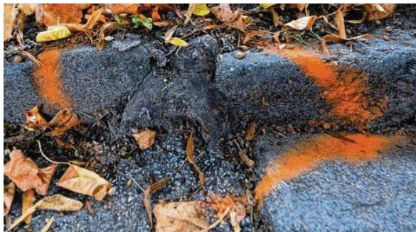
Mit Sprühfarbe sind Wurzeln gekennzeichnet worden, die aus dem Pflaster oder dem Bordstein ragen.
