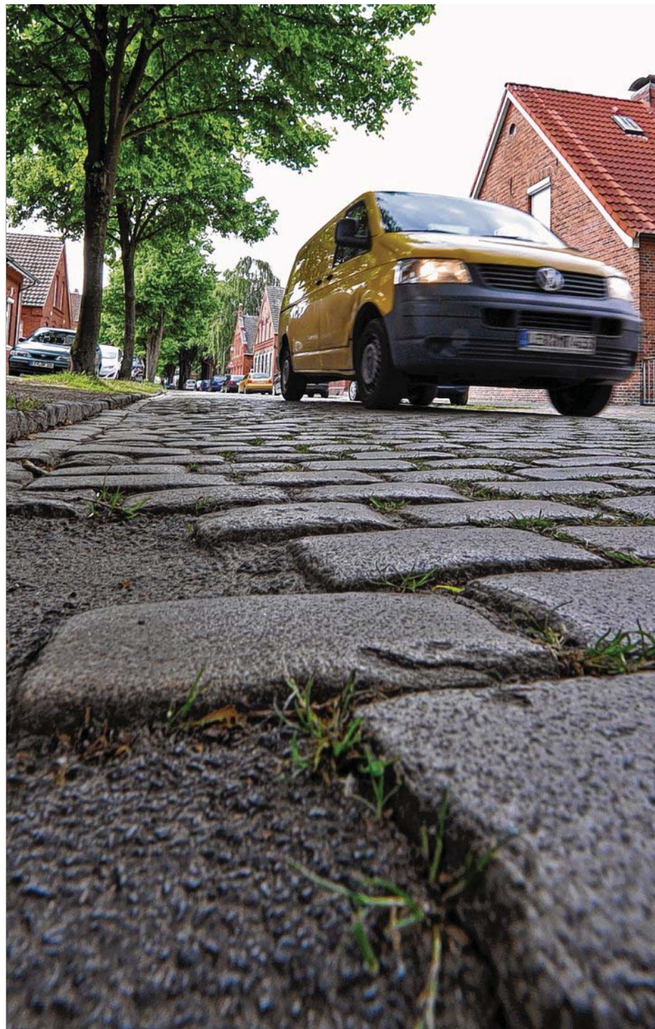
Die Ulrichstraße ist schon länger in einem schlechten Zustand.
