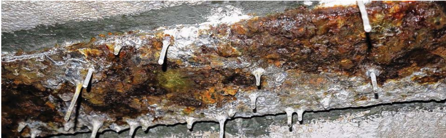
Die Eisenträger im Tunnel sind verrostet. „So, wie der Zustand dort jetzt ist, würde ich da ohne Helm nicht mehr durchlaufen wollen“, sagte der Gutachter Edzard Wulf.
