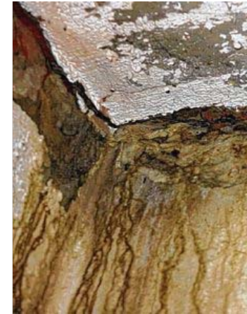
An mehreren Stellen ist Wasser eingedrungen.
