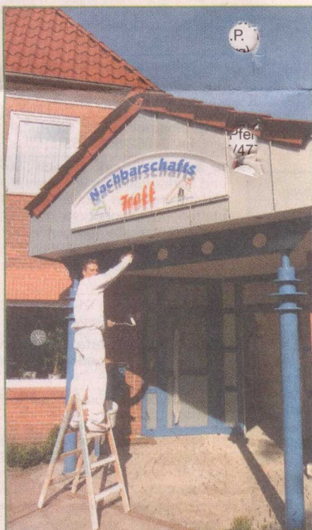
Ein Veranstaltungsraum für rund 120 Besucher ist in der Evenburgallee 51 als Anbau an den bestehenden Nachbarschaftstreff des Bauverein Leer eG entstanden.
